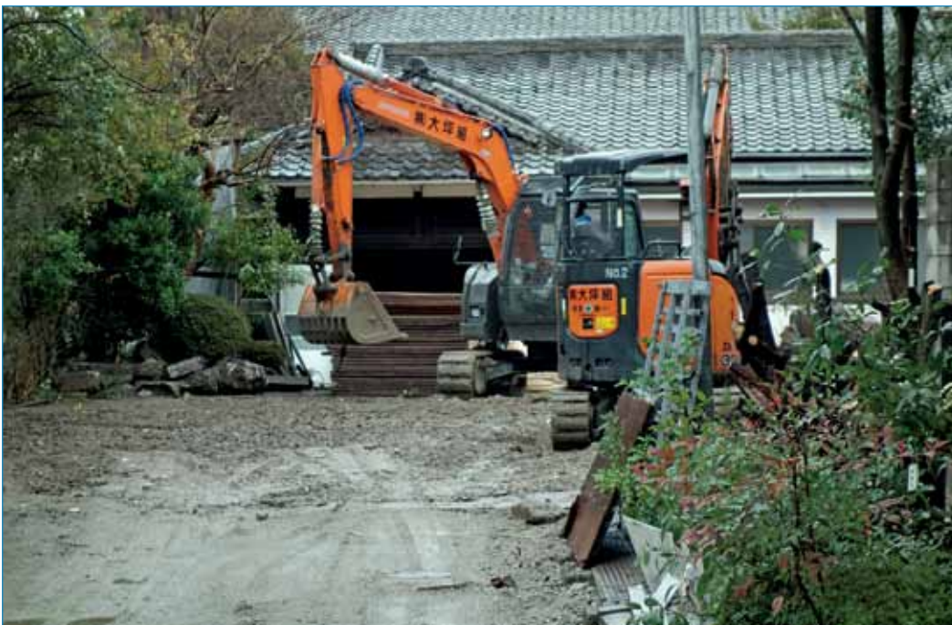
L'hôpital Sansei la veille de sa destruction. Photo de l'auteur de l'article. Kyoto, le 26 février 2015.
